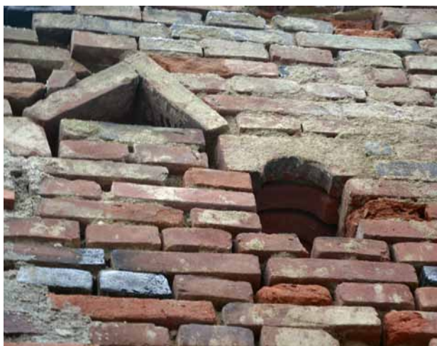
Obr. 21. Vysočany u Ovesných Kladrub, usedlost čp. 7. Východní (zadní) štítové průčelí hlavního domu – detaily otvorů zřejmě do holubníku v půdním prostoru nad arkádovým zápražím. (Foto K. Knotová, 2013–2014)
