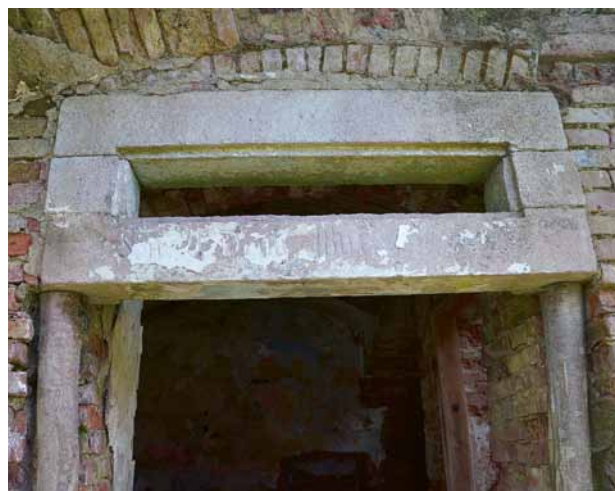
Obr. 20. Vysočany u Ovesných Kladrub, usedlost čp. 7. Horní část torza kamenného vstupního portálu s nadsvětlíkem do hlavního obytného domu. V nadpraží vytesán nápis „Johann(?) Denk 1867. Nro 7“. (Foto K. Knotová, 2013–2014)
