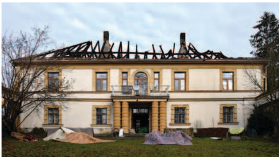
Pohled na jižní fasádu a shořelý krov zámku v Dolních Tošanovicích (foto Jana Koudelová, 2015).
