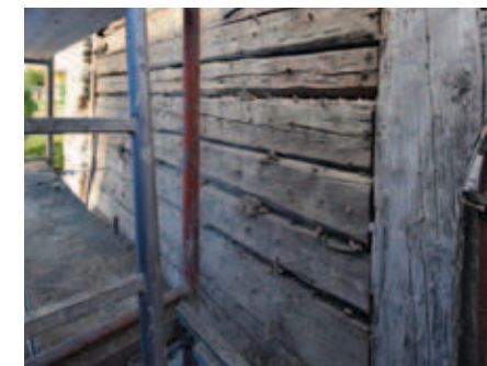
Západní úsek odkrytého roubení na jižní fasádě kaple sv. Rodiny v Odrách (foto Jana Koudelová, 2015).
