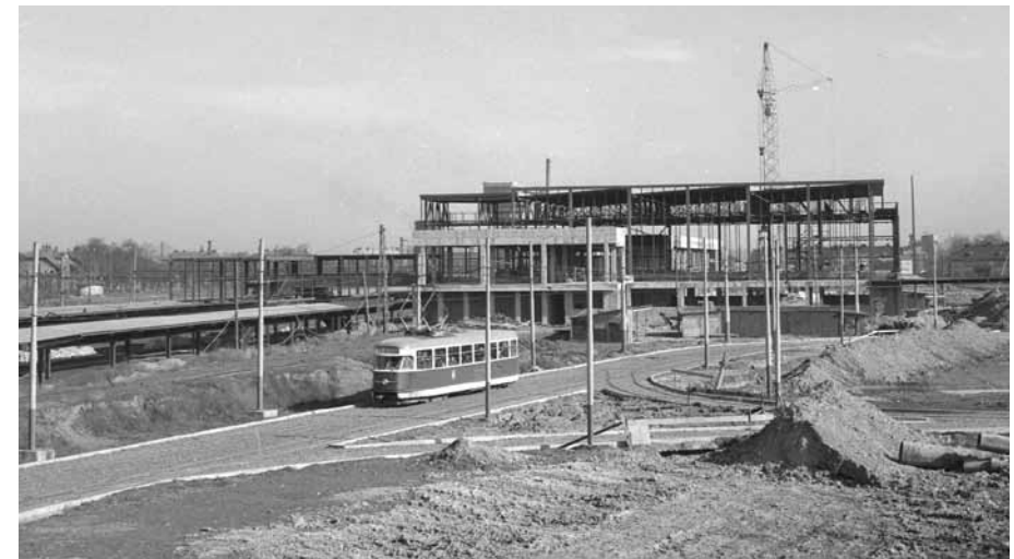
Výstavba železničního nádraží Ostrava-Vítkovice se zachycenou tramvajovou tratí směrem do Ostravy-Zábřehu (Archiv VÍTKOVICE, a. s., fond: Vítkovice, s. p., foto – negativy).
