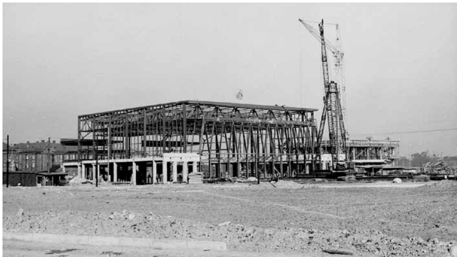
Výstavba železničního nádraží Ostrava-Vítkovice – ocelová konstrukce hlavní části budovy (Archiv VÍTKOVICE, a. s., fond: Vítkovice, s. p., foto – negativy).
