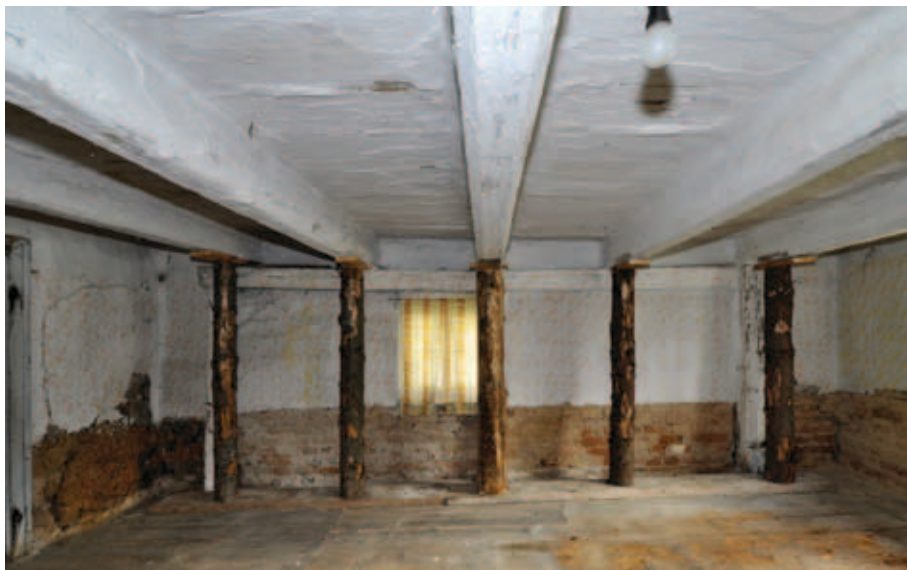
Pohled na jižní stěnu hlavní světnice v přízemí domu č. p. 120 v Bohušově (foto Dagmar Alterová, 2016).
